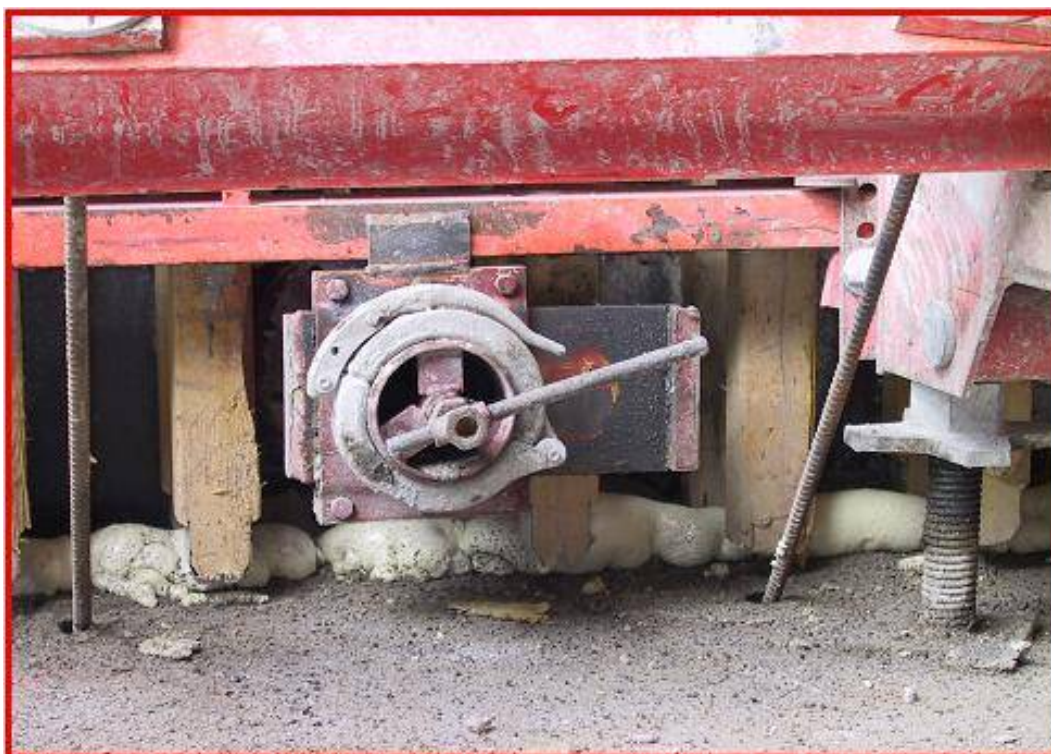
Obrázek 5: Po plnění bednění od spodu je přečnávající beton setřen podél vnitřního povrchu bednění pomocí speciální hřídelky nebo je povrch opraven po odbednění.
