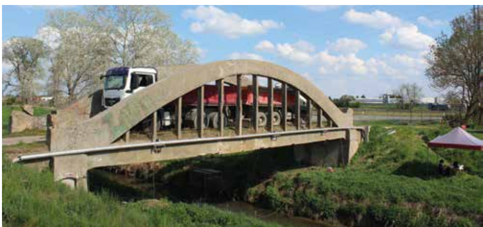
1 Pohled na most při zatěžovacím stavu LC2 2 Vybraná místa poruch konstrukce: a) podélník s dobetonovanou částí, b) spodní líc nosné konstrukce s dobetonovanými prvky a původní příčník s obnaženou výztuží 1 View of the bridge – load case LC2 2 Examples of the deterioration of structural members: a) part of the recasted longitudinal girder, b) damaged and then repaired structural members of the bridge (view of the underside)
