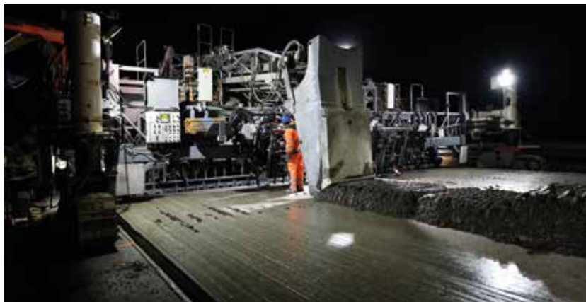
4 Pokládka CBK v nočních hodinách 4 Placing of concrete pavements in night hours
