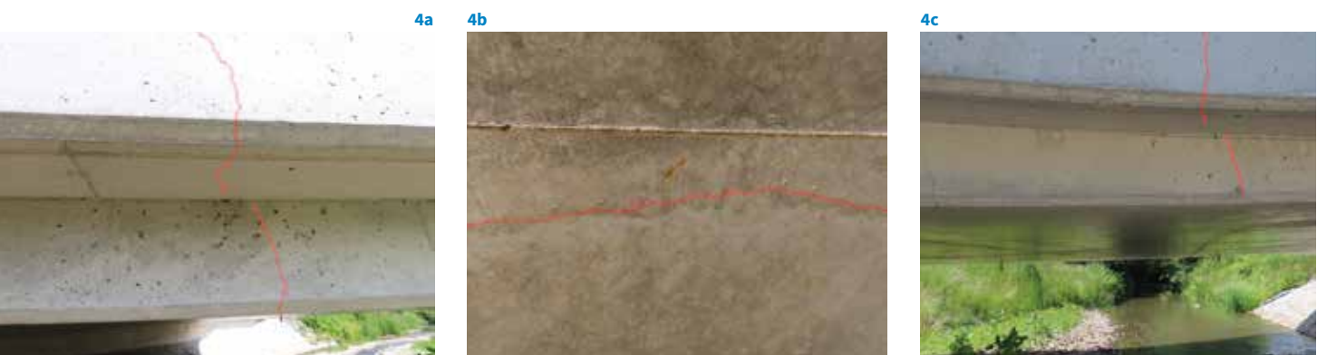
4 Souvislá trhlinka šířky větší než 0,1 mm uprostřed rozpětí rámové přičle zaznamenaná po dvou letech užívání mostu: a) návodní strana, b) pohled nosné konstrukce, c) povodní strana 5 Výsledky studie stanovení zbytkové životnosti rámového mostu – modelování degradačních procesů 4 Continuous crack greater than 0.1 mm wide in the middle of the frame span recorded after two years of bridge use: a) upstream side, b) substructure bottom view, c) downstream side 5 Results of a study of the residual service life assessment – modelling of deterioration processes
