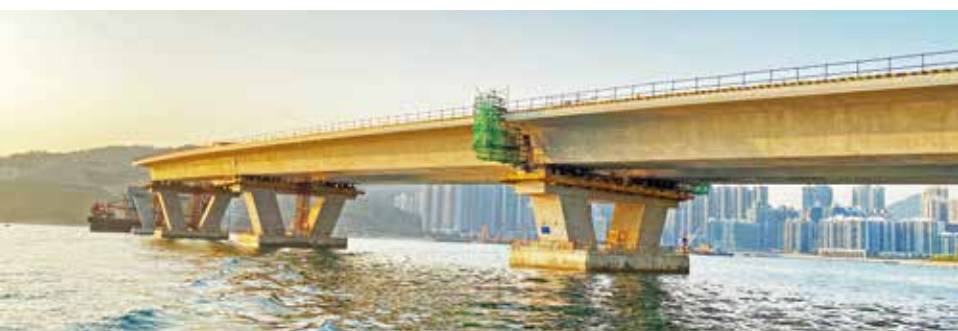
1 Pohled na dokončený prefabrikovaný betonový pilíř (pohled z moře) 2 Dokončené prefabrikované betonové pilíře (pohled z jihu)
