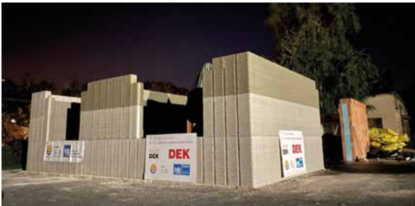
4 Pilotní objekt vybudovaný technologií Dekmatic 5 Detail gripu pro robotické zdění 7 6 Technologie 3D tisku za chodu v automatickém režimu 7 Noční pohled na hotový objekt 4 Mock-up structure built using the Dekmatic technology 5 Detail of the attachment for the robotic bricklaying 6 The 3-D printing in action, in the automatic mode 7 Night-time view of the structure
