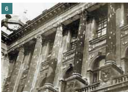
Obr. 5 Budova poškozená bombou 7. května 1945 ■ Fig. 5 Damage caused by a bomb on May 7, 1945
