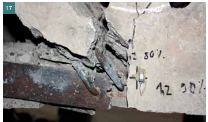
Obr. 17 Roztrhnutie výstuže spodného pásu (foto pred celkovým kolapsom nosníka) ■ Fig. 17 Rupture of reinforcement of the bottom flange (photo before failure of the whole girder)
