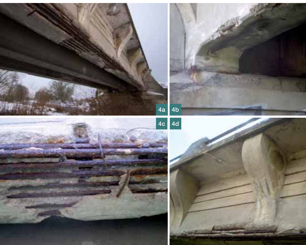
Obr. 4 Současný stav mostu: a) spodní líc mostu s korodující výztuží, b) uložení trámu, c) detail výztuže, d) detail krajního trámu
