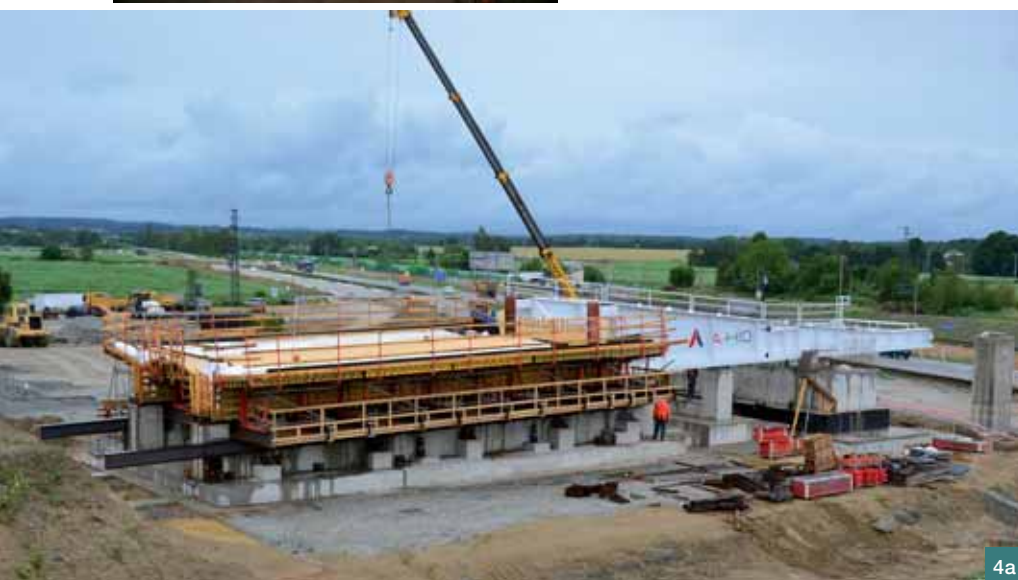
Obr. 3a,b,c Podepření těžkou skruží – podepření mostu v havarijním stavu na D1 u Hvězdonic pomocí těžkého podschržení z věží systému VST
