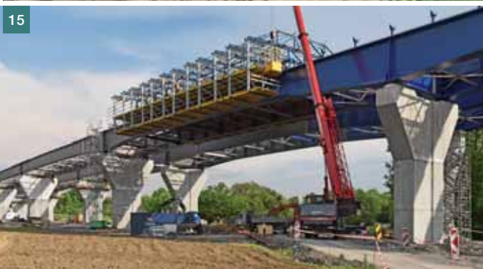
Obr. 9 Betonáž základových patek pomocí rámového bednění Framax ■ Fig. 9 Concreting the column shoes realized with Framax framed formwork
