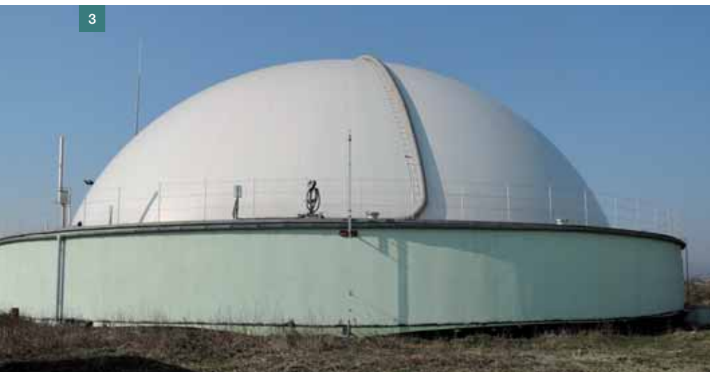
Obr. 3 Nádrž koncového skladu s membránou na uskladnenie bioplynu ■ Fig. 3 Terminal storage tank with a membrane roof for biogas storage
