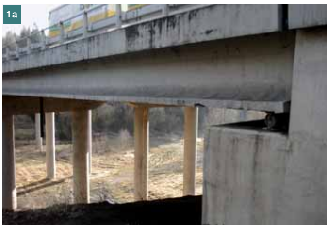
Obr. 1a,b Porucha betonu nosníků ■ Fig. 1a,b Failure in the concrete of beams
