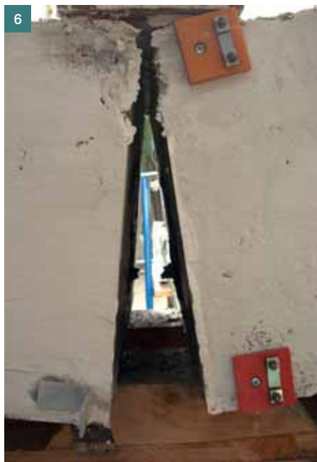
Obr. 6 Tahové porušení trnu ■ Fig. 6 Dowel failure in tension
