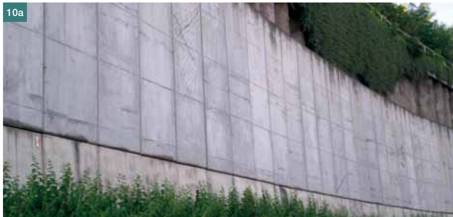
Obr. 9a, b Vady na stěnách v důsledku nedostatečně staženého bednění
