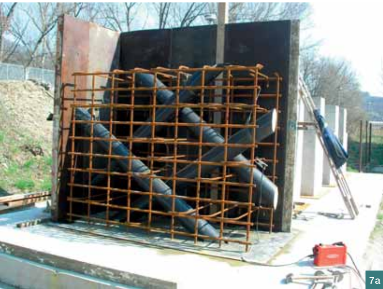
Obr. 4 Konstrukční schéma fyzikálního modelu vyrobeného pro VUT v Brně | Fig. 4 The design of a concrete test specimen by the TU in Brno
