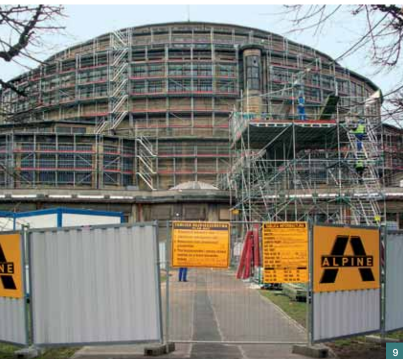
Obr. 9 Hala století při zahájení sanačních prací, 2009 ■ Fig. 9 Hall of the Century during the start of the repair work, 2009
