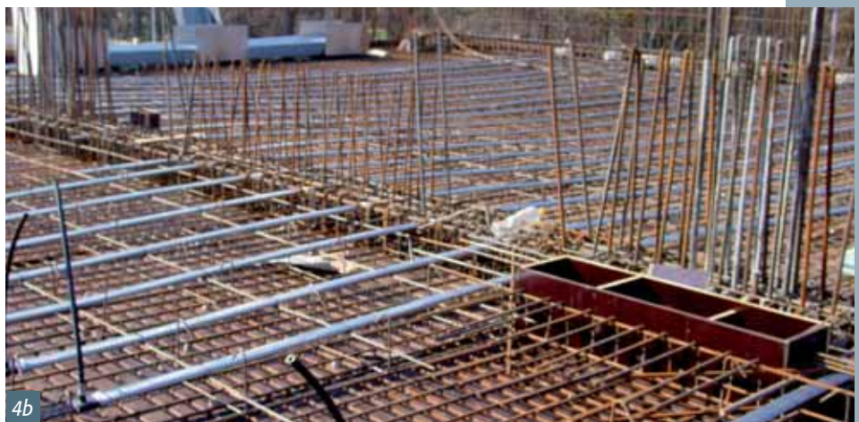
Obr. 4 Kotvy předpínacího systému – provádění Fig. 4 Anchors of the prestressing system – cables setting
