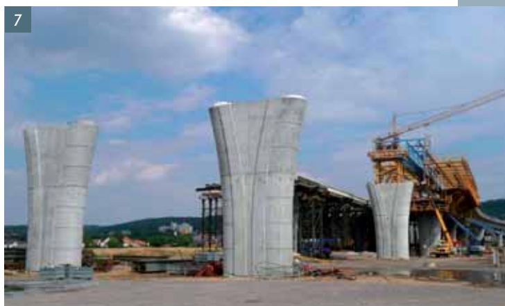
Obr. 8 Tvar pilířů rámového mostu v místě letmé betonáže Fig. 8 Shape of the pillars of the frame bridge in the place of free-cantilever concretings
