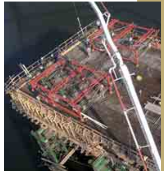
Obr. 5 Instalace kotev závěsů před betonáží Fig. 5 Installation of the anchorages before casting
