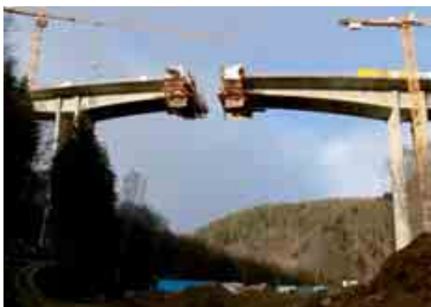
Obr. 11 Vahadla AB a CD před spojením Fig. 11 Balanced cantilevers AB and CD before closure
