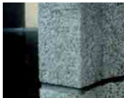
Obr. 6 Typická nejvíce poškozená místa fasády po odstranění narušeného betonu Obr. 7 Sanovaný betonový prvek
