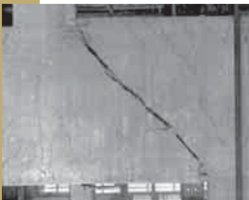
Obr. 6 Experiment, stav porušení po zkoušce
