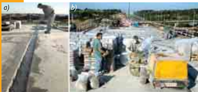
Obr. 8 Montáž příčných desek, a) plnění spár mezi deskami, závlivka i s přidavkem kameniva dobře niveluje, b) šnekové čerpadlo s míchacím centrem pro přípravu závlivkové směsi, c) osazení příčných desek na U nosníky, zvýrazněná kotvící výztuž zasahující do otvorů v deskách, d) protékající závlivka v ložné spáře mezi deskami a U nosníky
