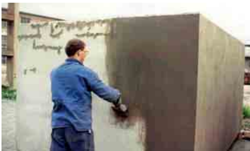
Obr. 3 Postup při opravě trhlin a celkové natření domovní železobetonové jímky krystalizačním materiálem
