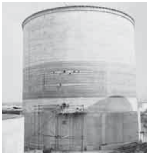
Obr. 7 Nádrž po napnutí vodorovných kabelů a části ovinutí před nástřikem ochranné cementové omítky Fig. 7 The tank after horizontal prestressing of tendons and a part of winding before shotcreting the cover layer
