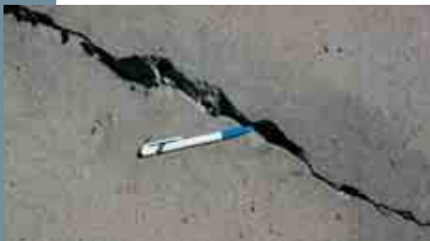
Obr. 8 Při inventarizaci poruch zjištěná trhlinka velké závažnosti
