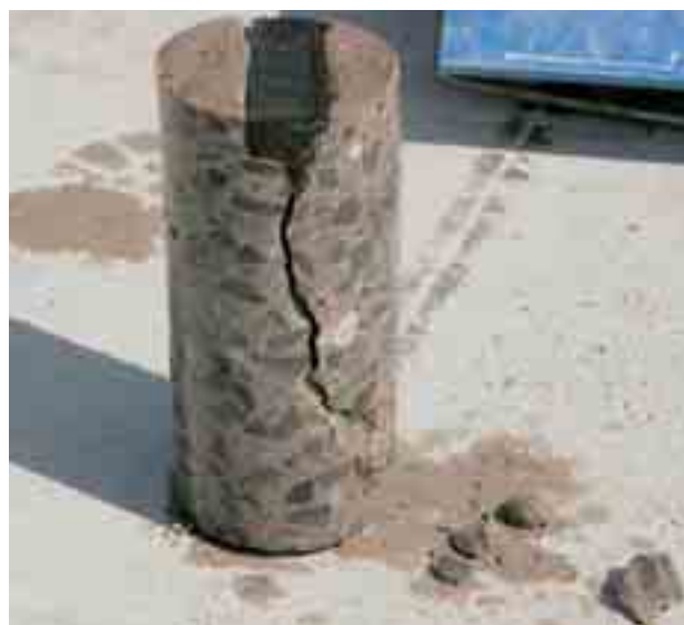
Obr. 13 Vrtné jádro ukazuje sklon a směr průběhu trhliny, šířící se od kontrakční spáry Fig. 13 The bore core shows the gradient and direction of the crack course spreading from the heading joint
