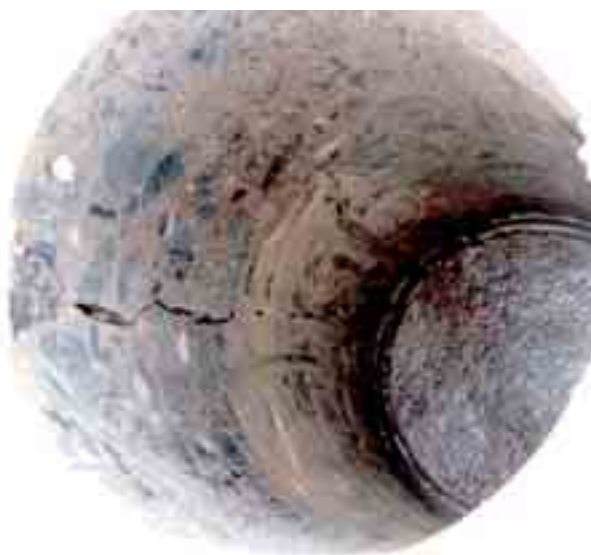
Obr. 12 Vnitřek vrtu provedeného přes trhlinu ukazuje sklon a směr průběhu trhliny Fig. 12 The inside of a hole made through the crack shows the gradient and direction of the crack course
