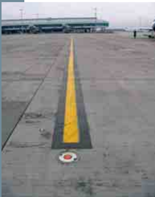
Obr. 1 Jedno z mnoha návěstidel v letištní vozovce Fig. 1 One from many lights in airport pavement
