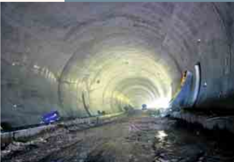
Výstavba tunelu Panenská na dálnici D8 Building of Panenska tunnel on the highway D8
