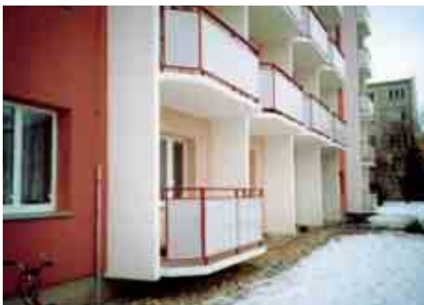
Obr. 2 Ukázka umístění lodžiového stropního panelu v patě stěny Fig. 2 Sample placement of a loggia ceiling panel at the base of the wall
