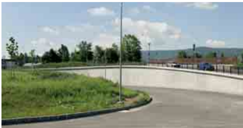
Obr. 1 Odbočující větev z I/35 na I/14 – opěrná zeď podél přeložky Doubská ulice
