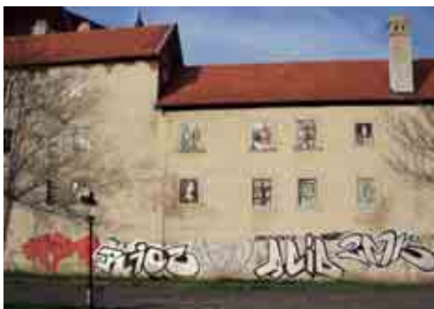
Obr. 2 „Vylepšená“ novozrekonštruovaná fasáda historickej budovy v centre mesta
