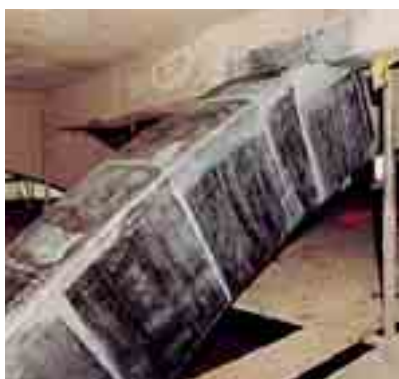
Obr. 6 Železobetonový oblouk zesílený obalením FRP laminátem
