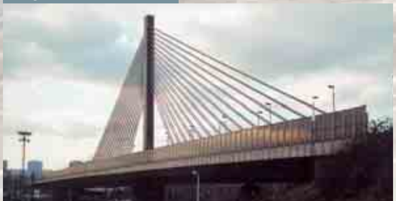
Oprava svodidlových zídek - most „Jižní spojka“ / Repair of guard walls – bridge „Southern Junction“
