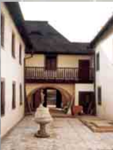
Hotel Gold Český Krumlov – kompletní oprava po záplavách Hotel Gold Český Krumlov – complete repair after floods
