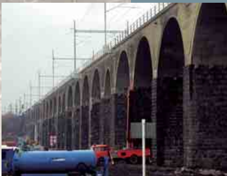
Sanace železničního viaduktu – Hranice na Moravě Maintenance of railway viaduct – Hranice na Moravě
