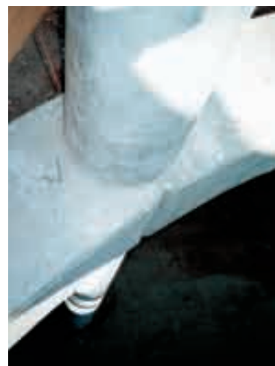
Obr. 8 Smontované příčle a sloupy kruhového prstence prosvětleného prostoru Fig. 8 Assembled cross-beams and columns of the circular ring of the brightened space
