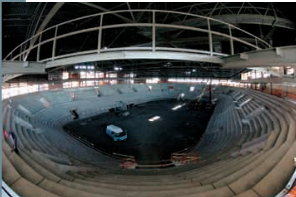
Obr. 18 Celkový pohled do halového prostoru Fig. 18 General view of the hall space
