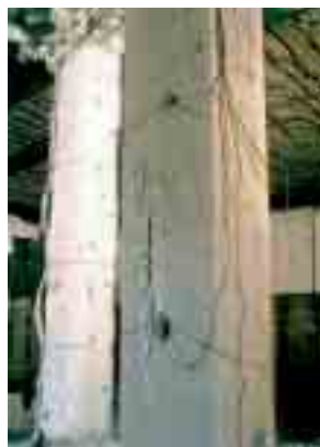
Sloup z vysokopevnostního betonu po požáru
