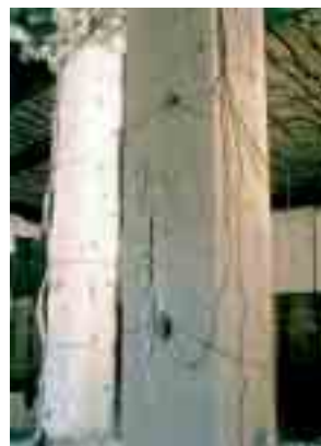
Sloup z vysokopevnostního betonu po požáru
