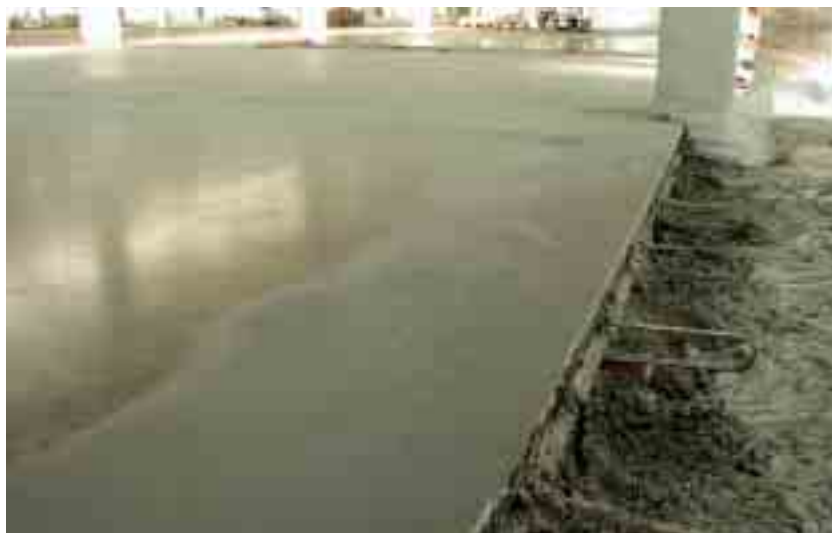
Obr. 2 Bednění podlahové desky při betonáži metodou vystřídání pásů Fig. 2 Formwork erection of the floor slab during concreting using the method of alternating strips
