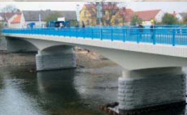
Most v Boršově nad Vltavou, rekonstrukce Bridge in Boršov Upon the Vltava, reconstruc- tion
