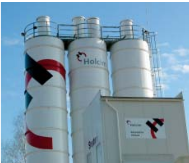
Obr. 5 Betonárna Jihlava Fig. 5 The mixing plant Jihlava
