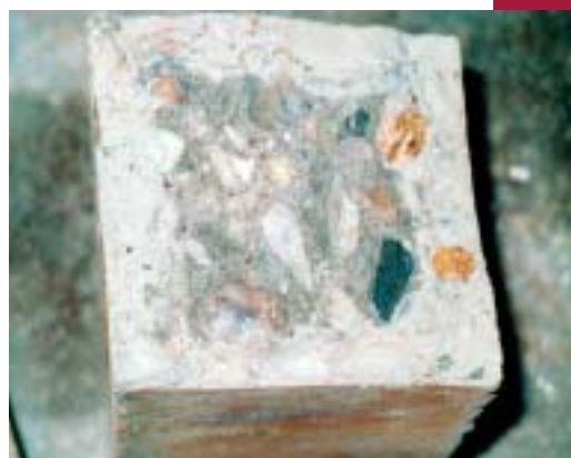
Obr. 4 Zlomená část betonového trávce Fig. 4 A broken part of a concrete beam
