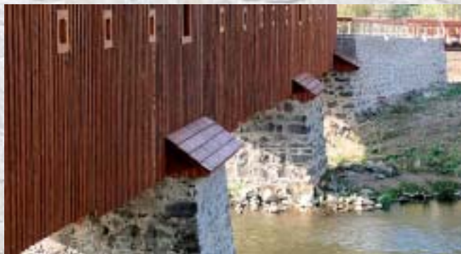
Rekonstrukce pilířů a nábrežních zdí mostu v Radošově Reconstruction of piers and quay walls of a bridge in Radošov
