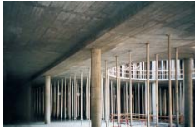
Obr. 10 Stropní konstrukce 1. NP s plochými průvlaky Fig. 10 Floor structure of the first storey with flat beams
