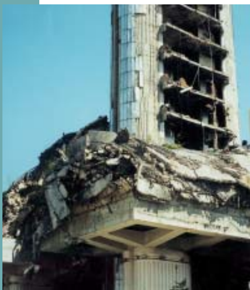
Obr. 2 Ruiny železobetonového objektu v Sarajevě
