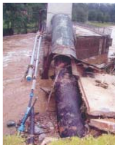
Obr. 8 Poškozený přívod do úpravně vody Plav
