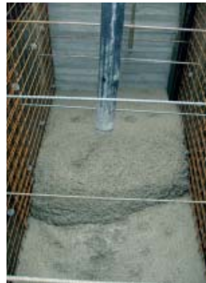
Obr. 2 Betonáž primárního stínění lineárního urychlovače baryto-magnetitovým betonem o objemové hmotnosti \rho = 2950 \text{ kg/m}^3
