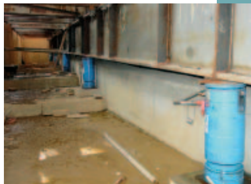
Obr. 5 Rošt ve výrobě podepřený hydraulickými lisami Fig. 5 Grid in casting yard supported by hydraulic jacks
