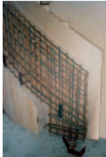
Obr. 3 Vyzávaná výztuž v místě vetknutí schodnice do podlahy
