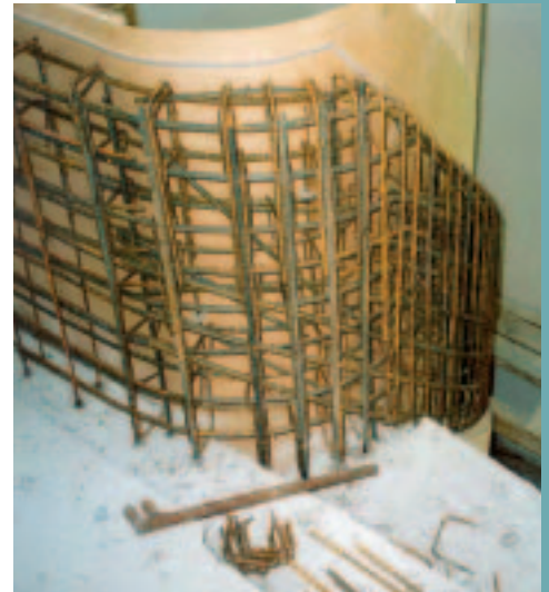
Obr. 4 Vyzávaná výztuž v místě opření schodnice o desku podesty
