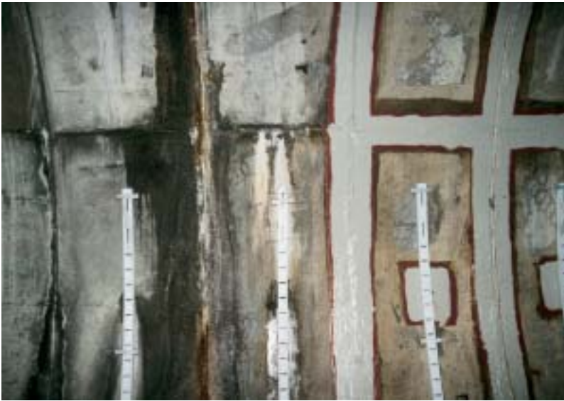
Obr. 2 Vlevo – nesanovaná část s průsaky, vpravo – provedená kompletní sanace spár tunelu Fig. 2 On the left – unrepaired part with seepages; on the right – completely repaired joints of the tunnel
